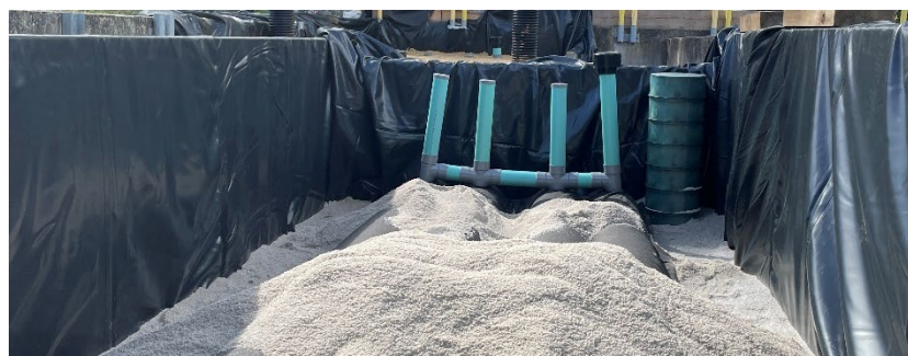
Figure 13 : Clarinette d'inspection et de ventilation DBO France
