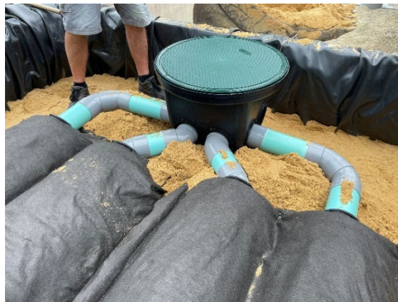
Figure 18 : Connection des conduites PVC avec les unités de traitement HBX
